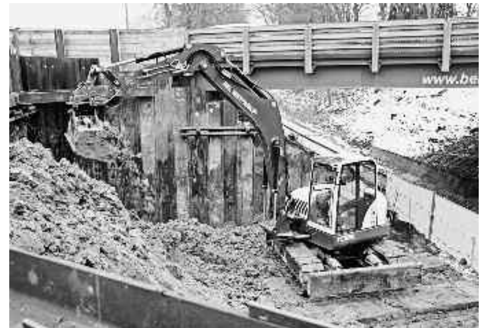
In 7,50 m Tiefe arbeitet ein Terex TC 125 Kompaktbagger aus dem HKL Mietpark an den Fundamenten der neuen Brücke in Lübeck. Foto: HKL
